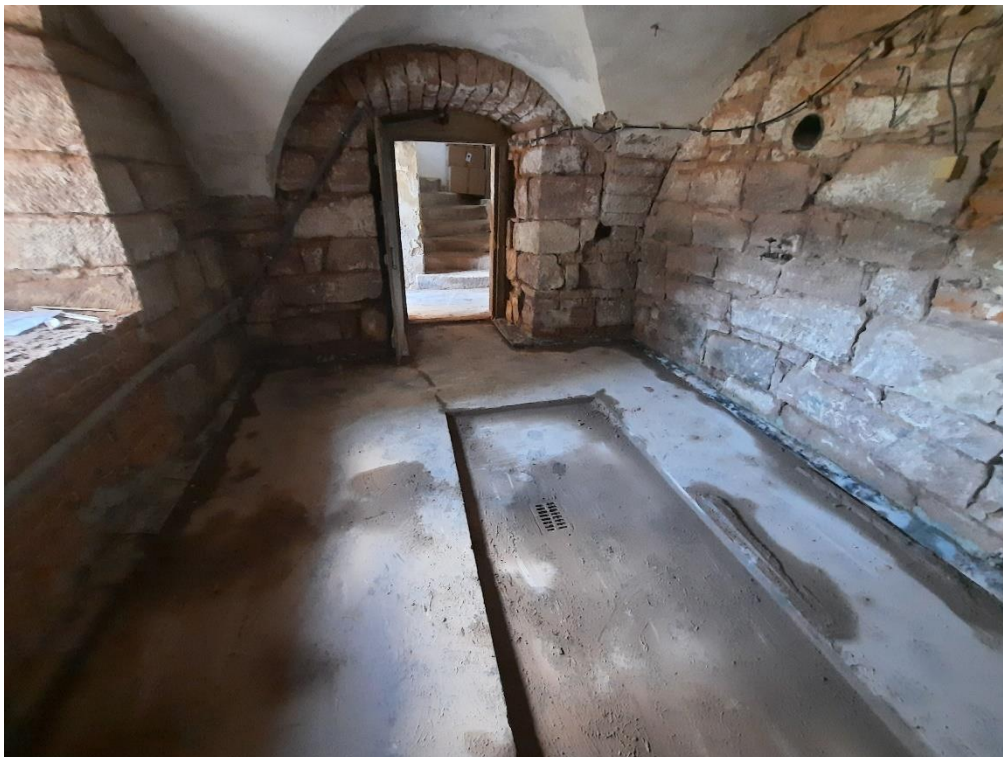
Muzeum – vodorovná izolace ve sklepě budovy
